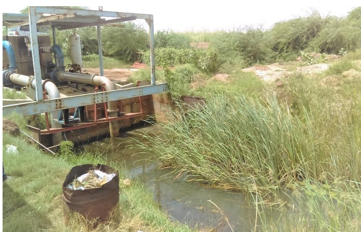
Photo 1 : moto pompe de drainage entre le lac et le canal de drainage des casiers de cannes de la CSS au niveau de Témèye Salane, (KA. S 2019)
