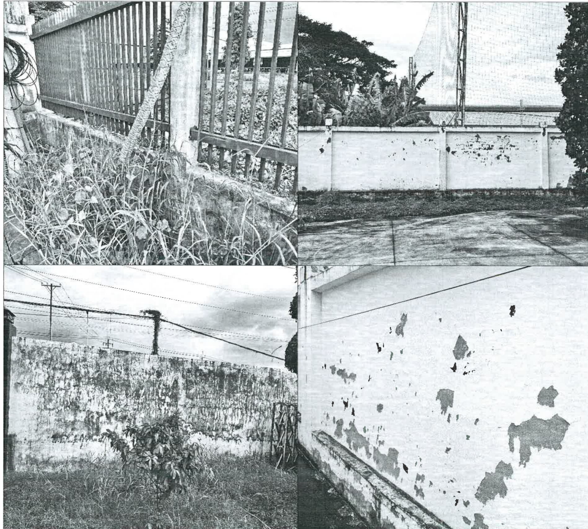
HIỆN TRẠNG TƯỜNG RÀO BỊ BONG TRÓC SƠN
