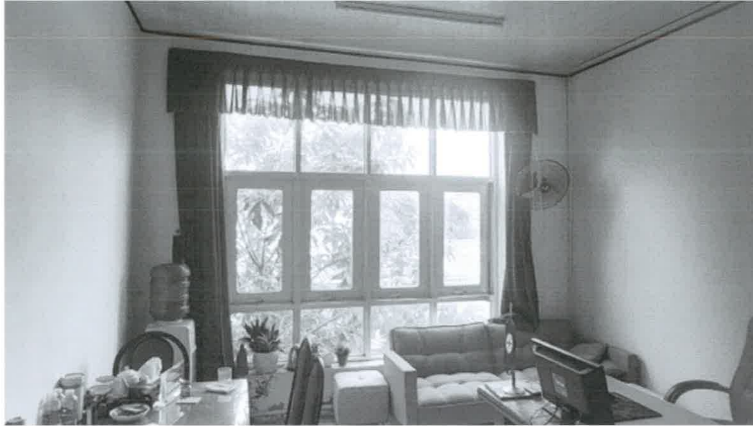
HIỆN TRẠNG CỬA BỊ HỎNG, KHÔNG KHÉP KÍN ĐƯỢC
