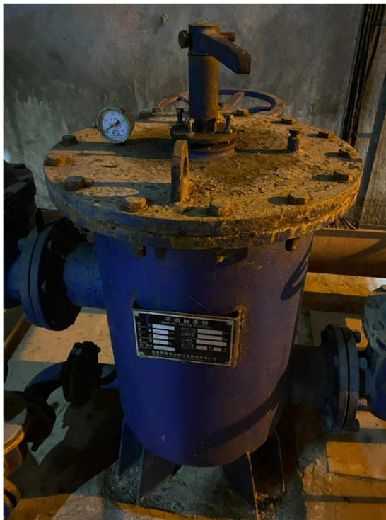
Hình ảnh bộ lọc hệ thống nước kỹ thuật bị han gỉ
