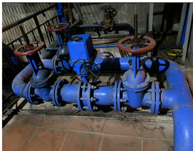
Hình ảnh các van và hệ thống đường ống bị han gỉ và bong tróc sơn
