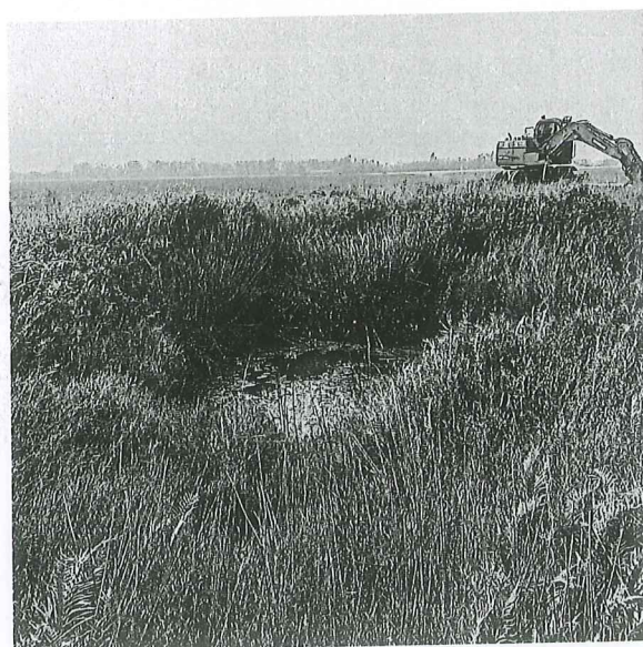
Hình 3: Hiện trạng khu vực ngập nước
