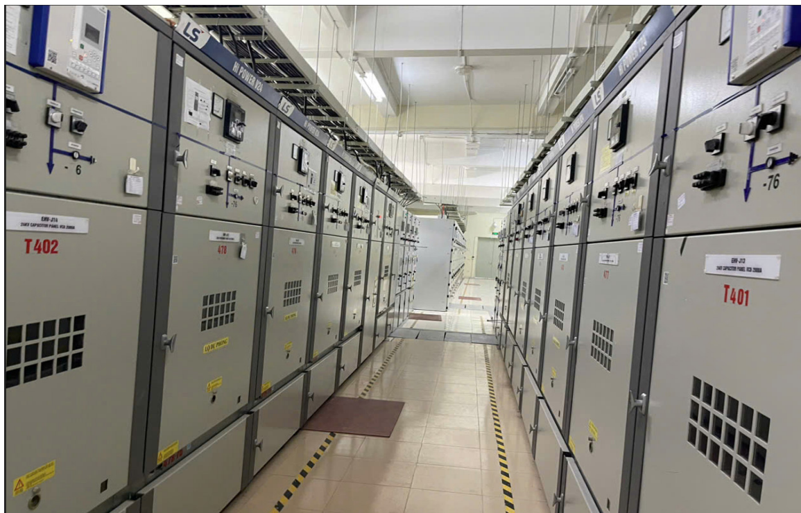
Dây tủ C41. C42 hiện trạng
