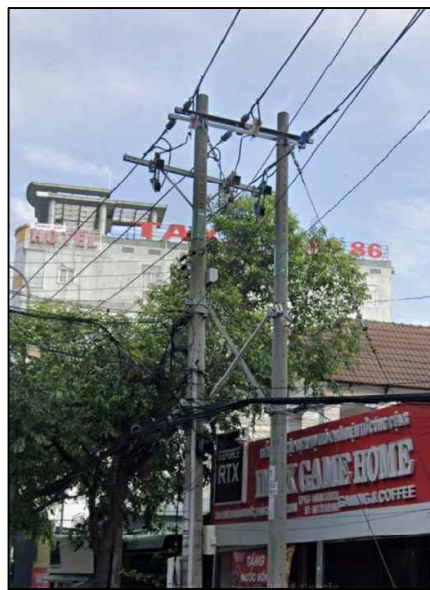
TRỤ 31 HIỆN HỮU NR SỔ CÔNG AN TUYẾN 474 MŨI DÙI
