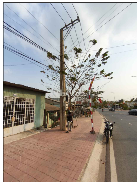
TRỤ 36 HIỆN HỮU NR LÒ LU TUYẾN 481 SAO QUỲ
