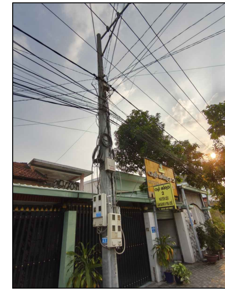
TRỤ 03 HIỆN HỮU NR CHỢ BẾN THẾ TUYẾN 481 SAO QUỲ
