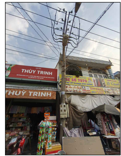
TRỤ 02 HIỆN HỮU NR CHỢ BẾN THẾ TUYẾN 481 SAO QUỲ
