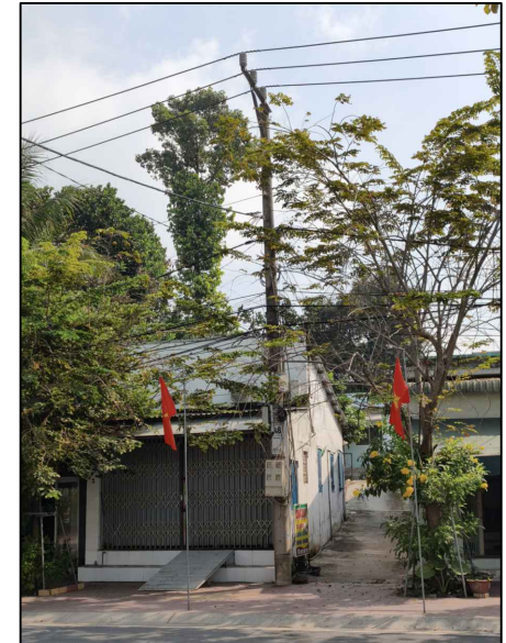
TRỤ 24B HIỆN HỮU NR LÒ LU TUYẾN 481 SAO QUỲ
