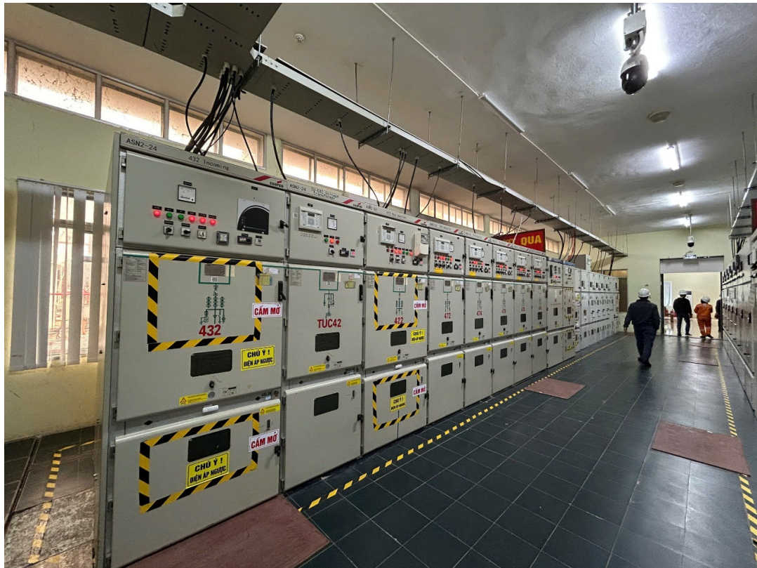
Dãy tủ C42 hiện trạng
