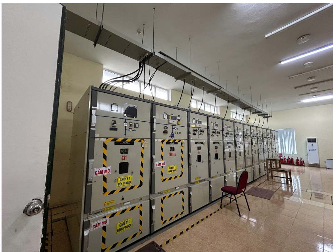
Dãy tủ C41 hiện trạng
