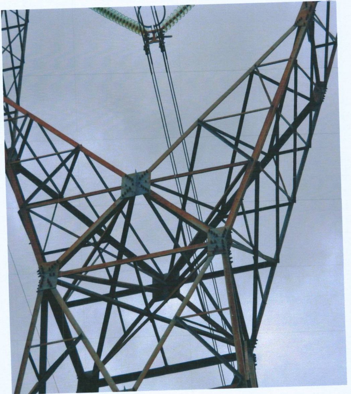
VỊ TRÍ 219 ĐZ 500KV 573,563 NMDNS2 – 580,581 T500HT
