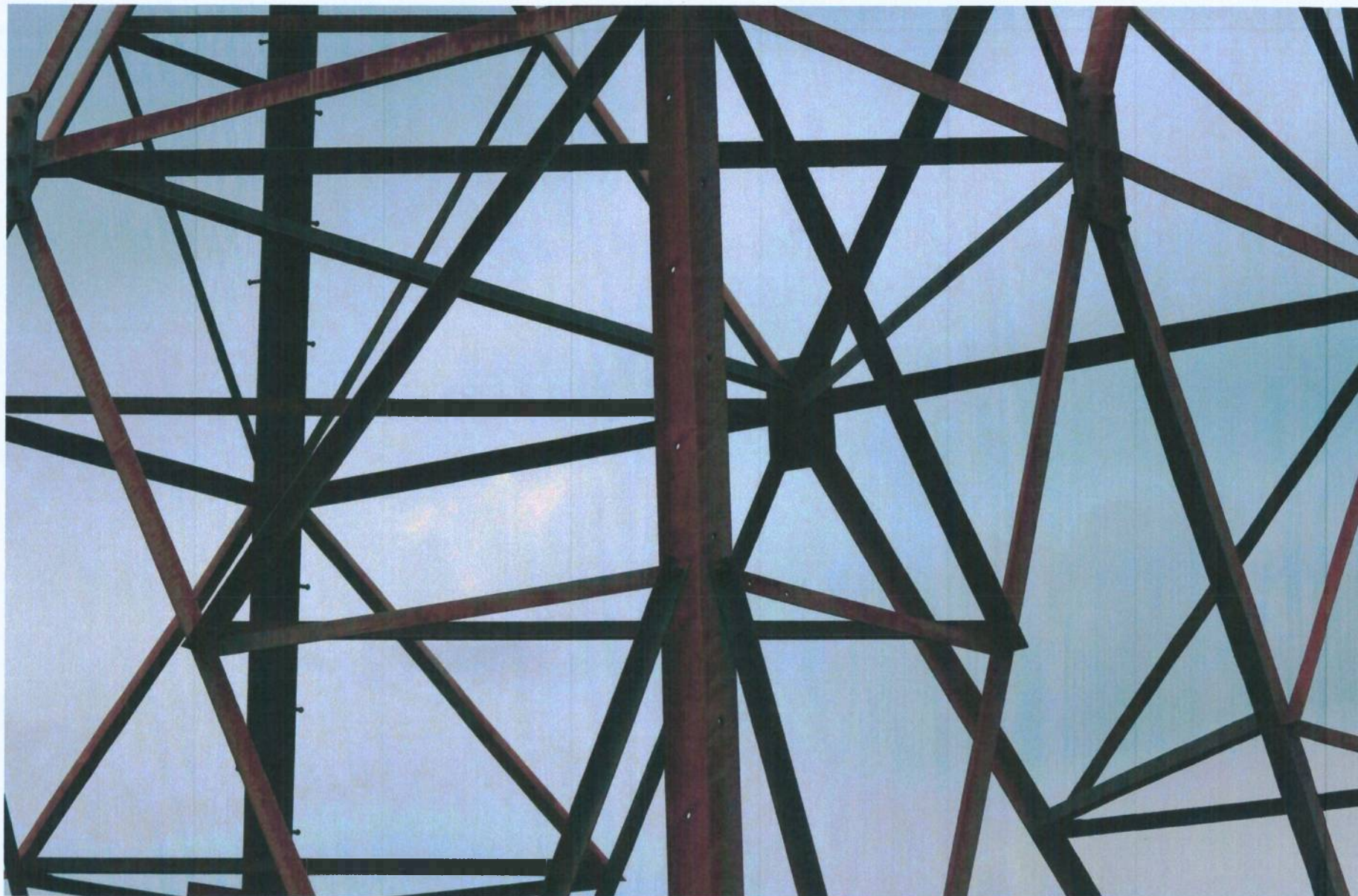
VỊ TRÍ 213 ĐZ 500KV 573,563 NMDNS2 – 580,581 T500HT
