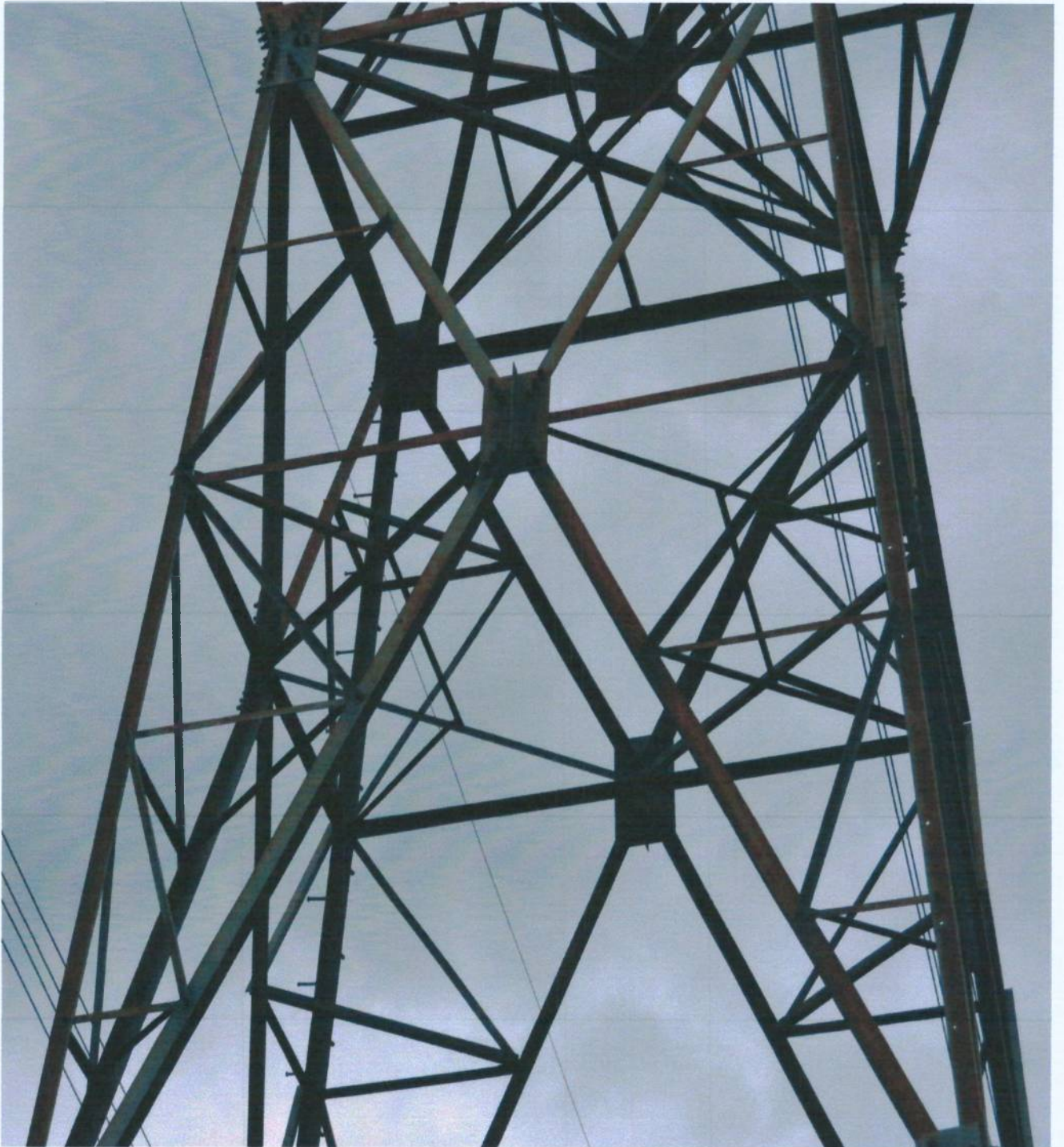
VỊ TRÍ 219 ĐZ 500KV 573,563 NMDNS2 – 580,581 T500HT
