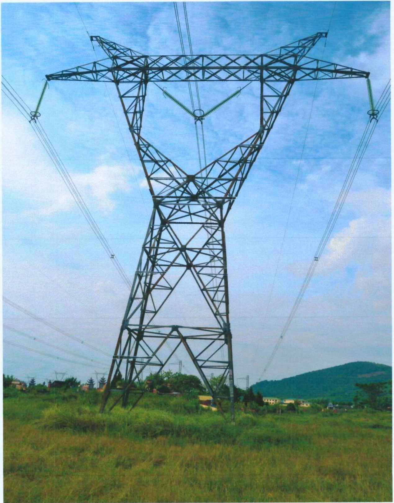
VỊ TRÍ 194 ĐZ 500KV 573,563 NMDNS2 – 580,581 T500HT
