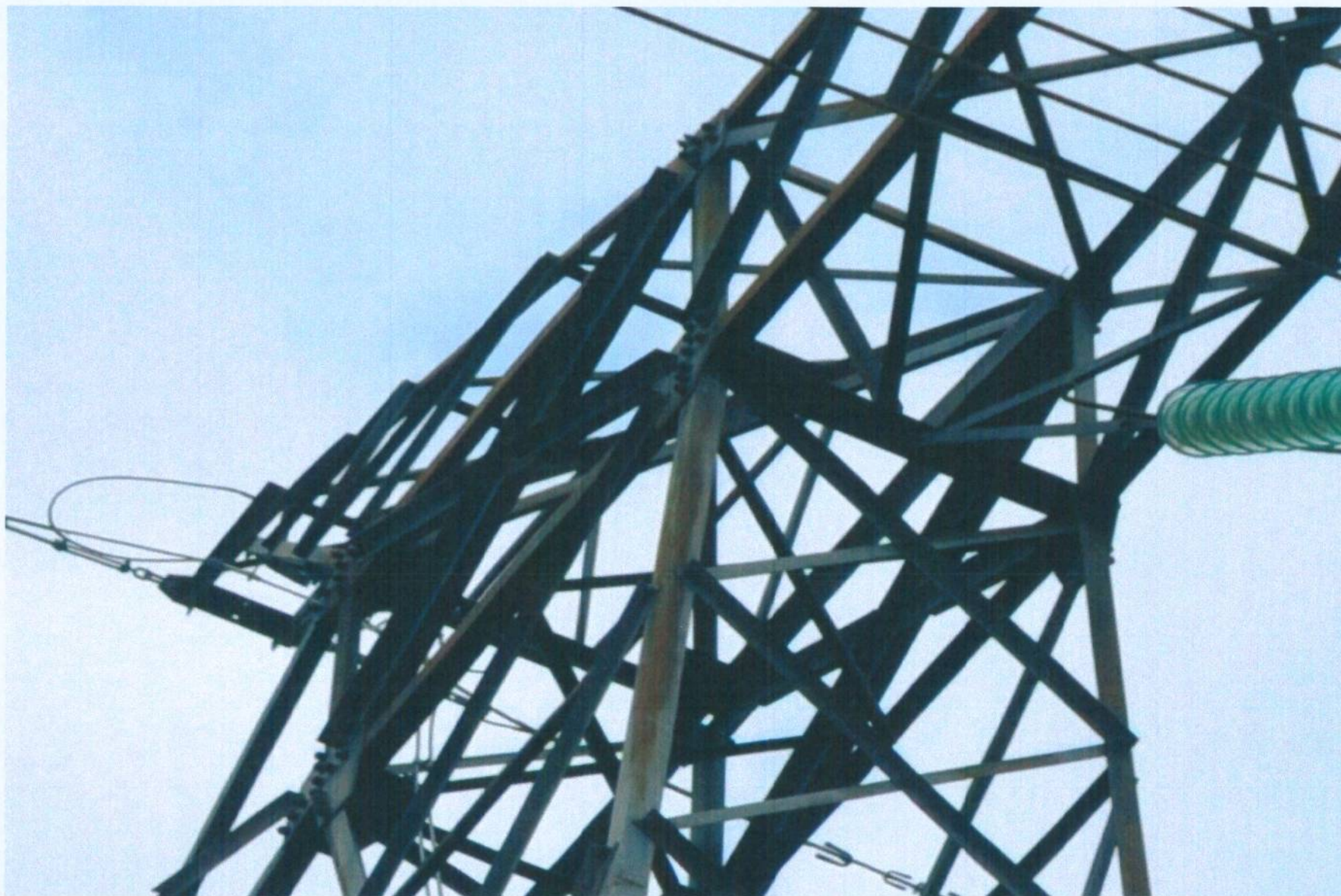
VỊ TRÍ 191 ĐZ 500KV 573,563 NMDNS2 – 580,581 T500HT
