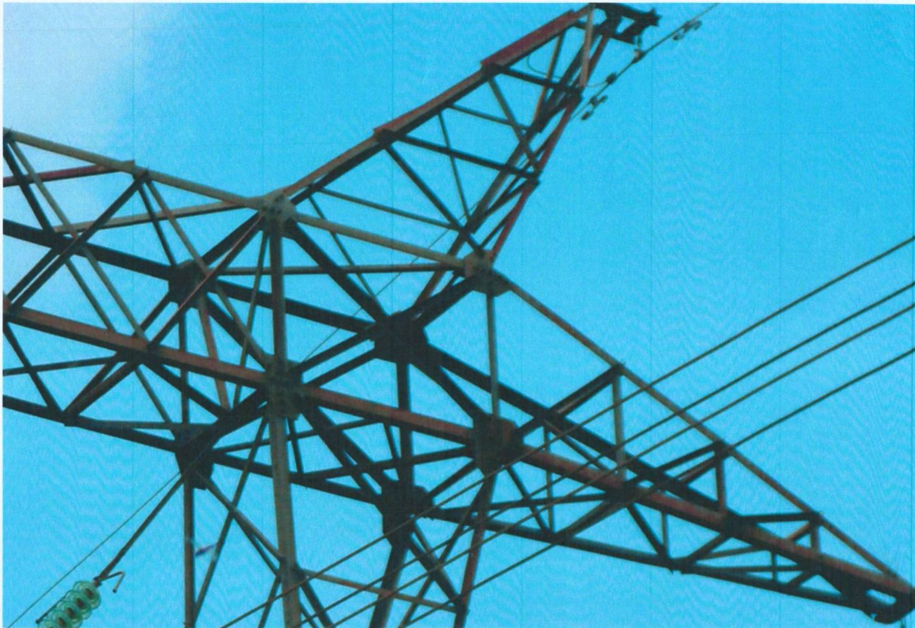
VỊ TRÍ 194 ĐZ 500KV 573,563 NMDNS2 – 580,581 T500HT
