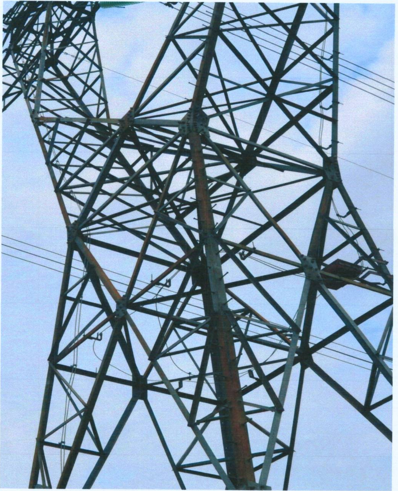
VỊ TRÍ 191 ĐZ 500KV 573,563 NMDNS2 – 580,581 T500HT
