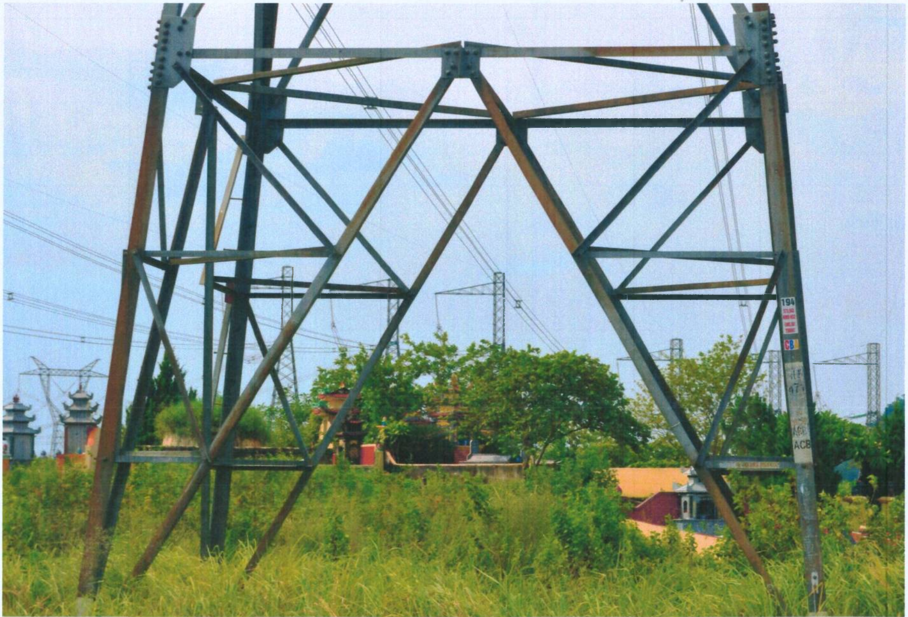
VỊ TRÍ 194 ĐZ 500KV 573,563 NMDNS2 – 580,581 T500HT
