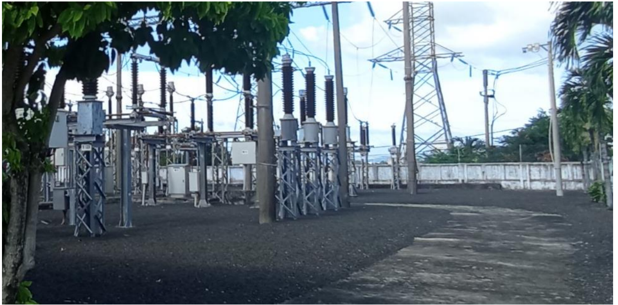
Hình 3. Tường rào hiện trạng phía Tây TBA 110kV Tuy Hòa
