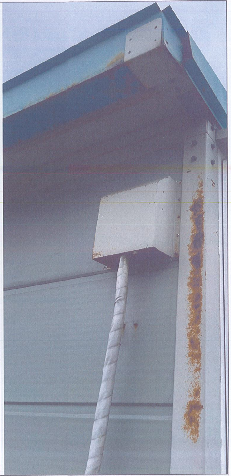
Hình ảnh tường nhà Bay housing bị hỏng
