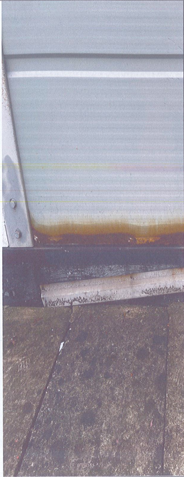
Hình ảnh tường nhà Bay housing bị hỏng
