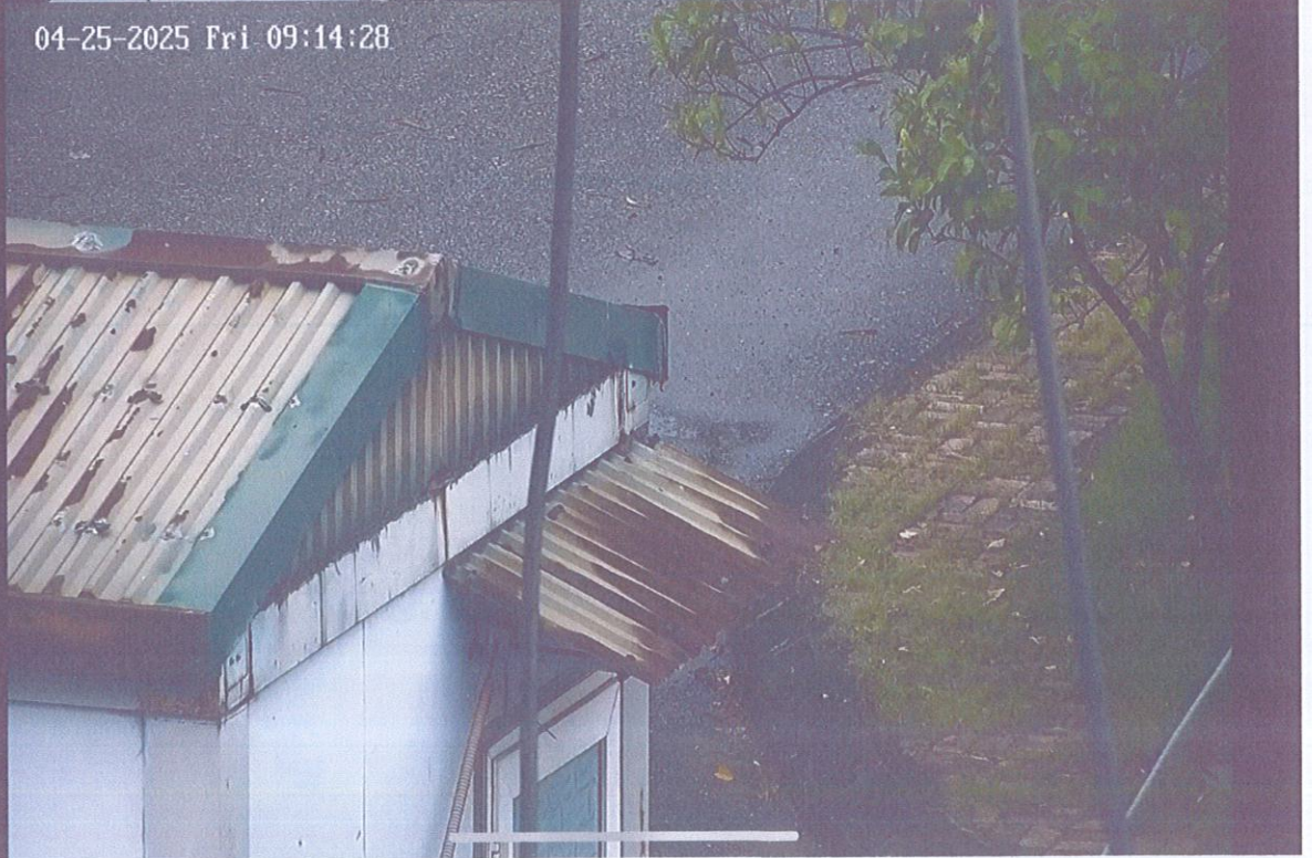
Hình ảnh mái nhà Bay housing bị hỏng
