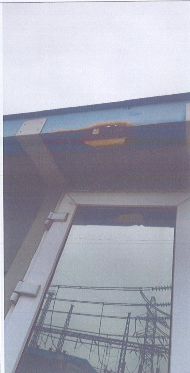
Hình ảnh mái nhà Bay housing bị hỏng
