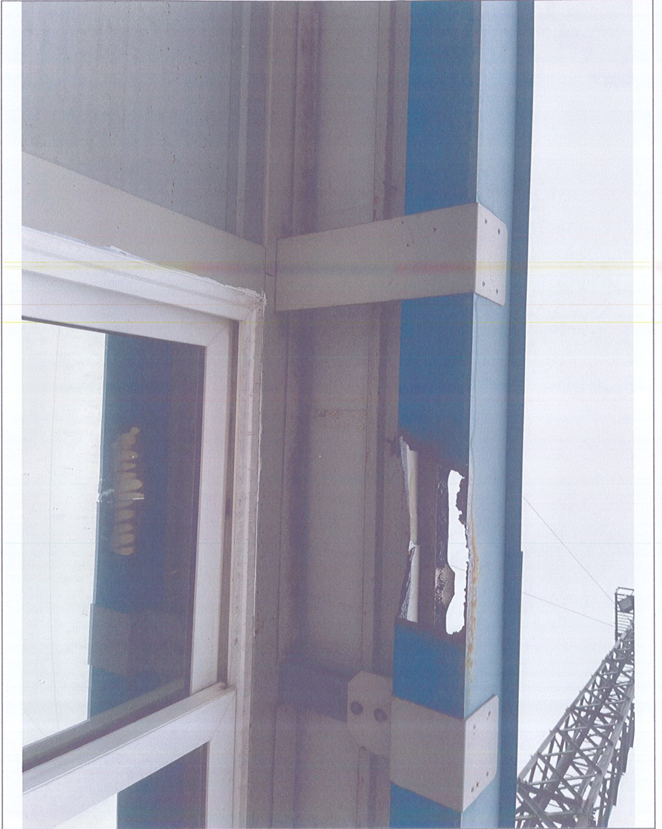
Hình ảnh mái nhà Bay housing bị hỏng
