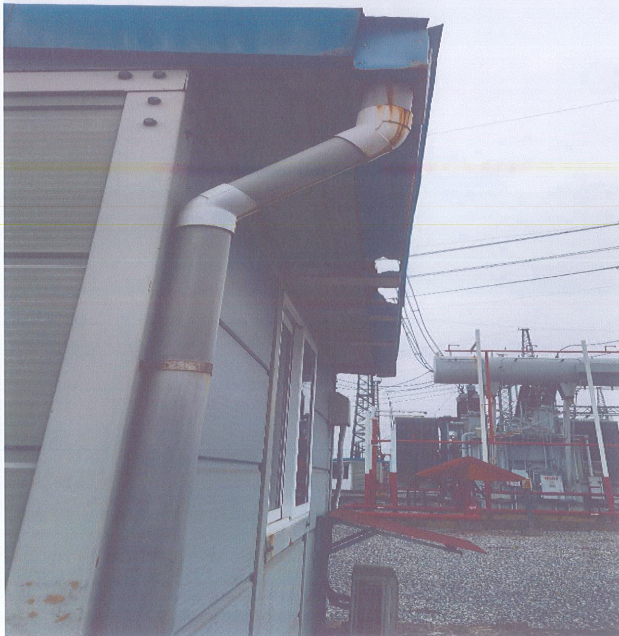
Hình ảnh mái nhà Bay housing bị hỏng
