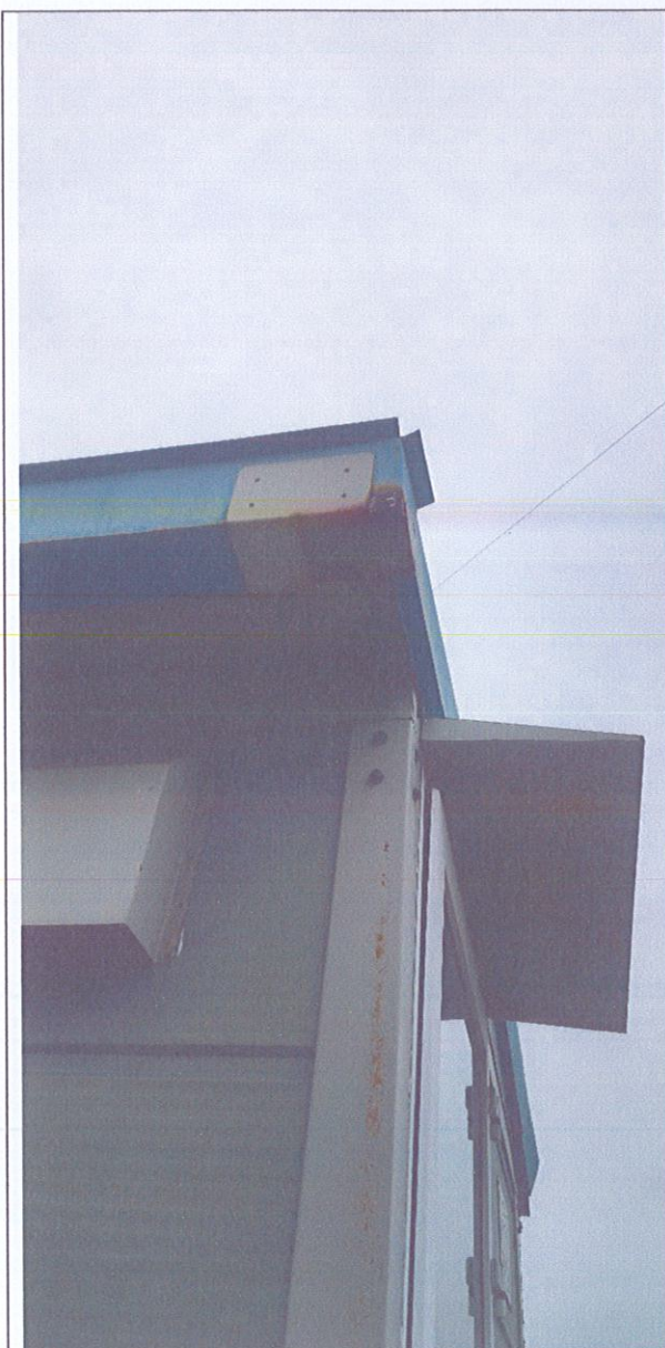
Hình ảnh mái nhà Bay housing bị hỏng
