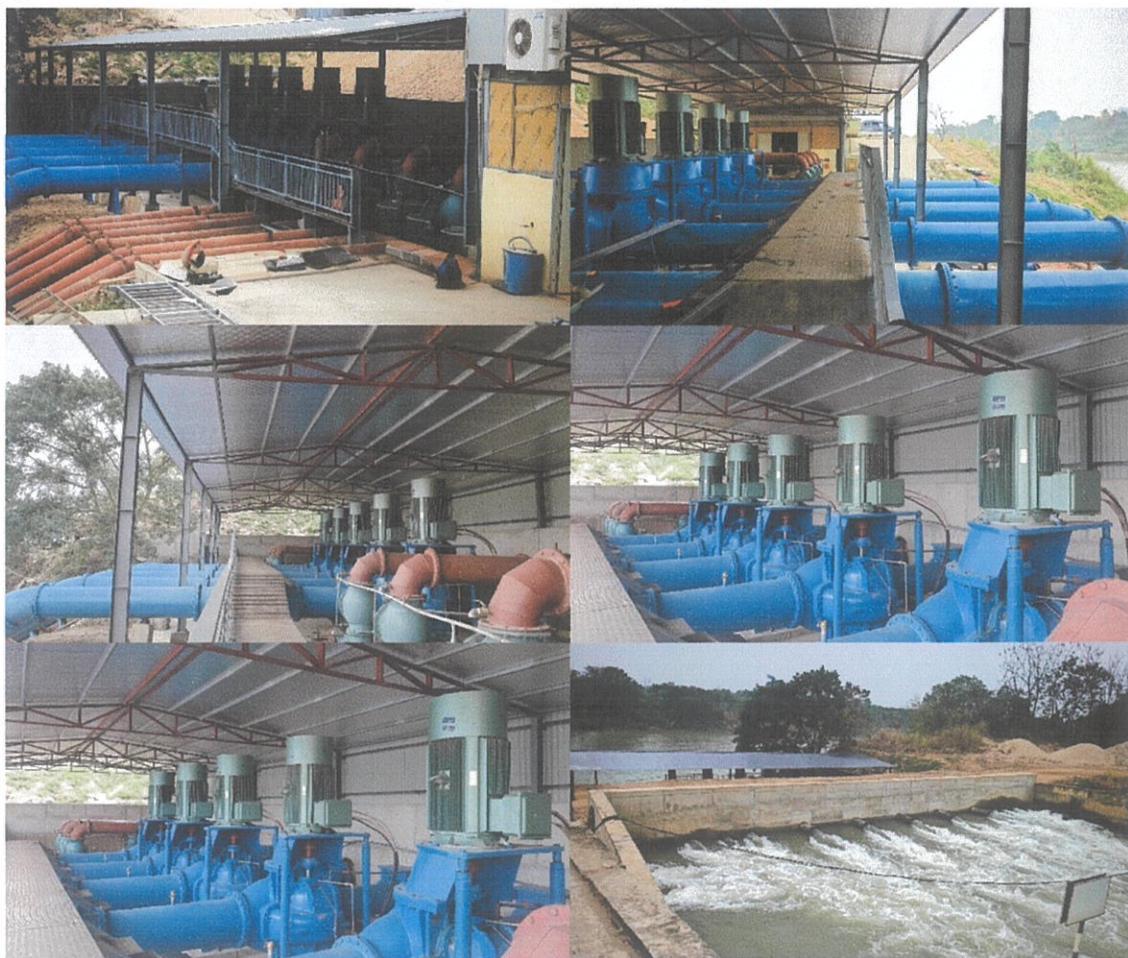
Hình 8. Các tổ máy bơm trạm bơm dã chiến Áp Bắc sau nâng cấp năm 2024
