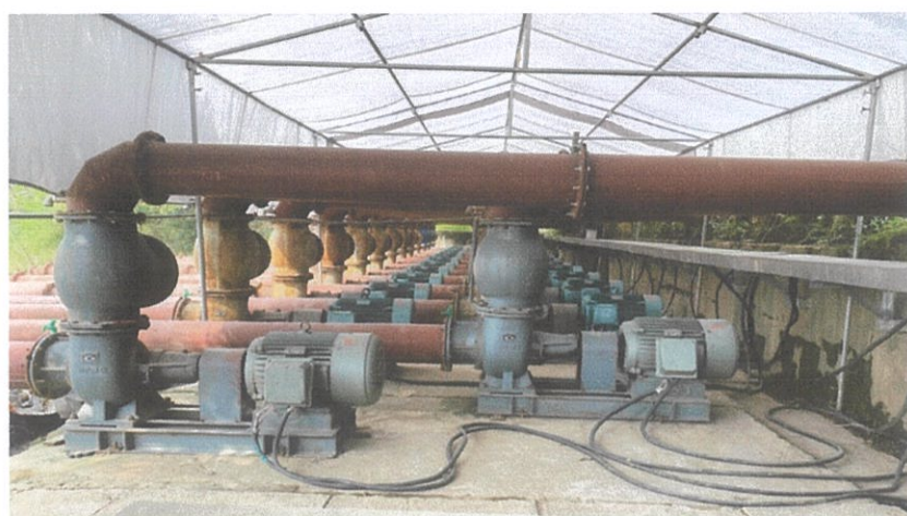
Hình 7. Trạm bơm dã chiến Ấp Bắc năm 2015
