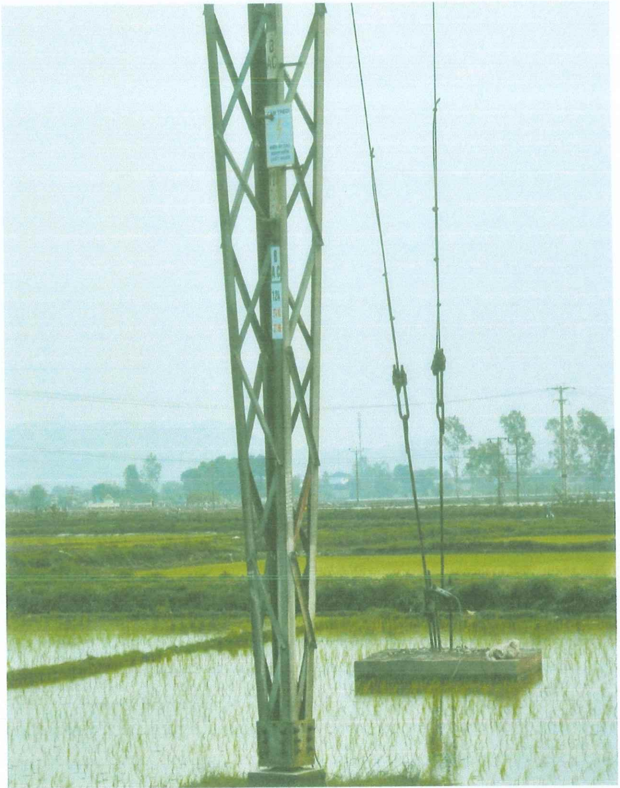
VỊ TRÍ 124 ĐZ 220KV 274 NS (E9.10) – 272 NC (E15.50)
