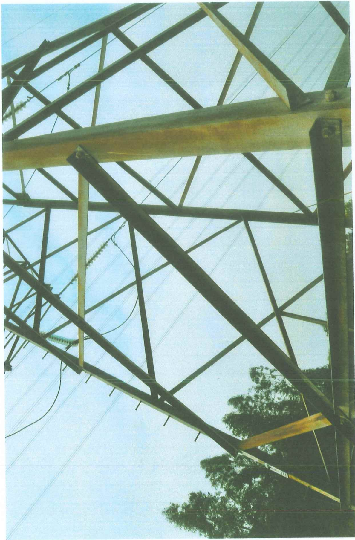
VỊ TRÍ 75 ĐZ 220KV 274 NS (E9.10) – 272 NC (E15.50)
