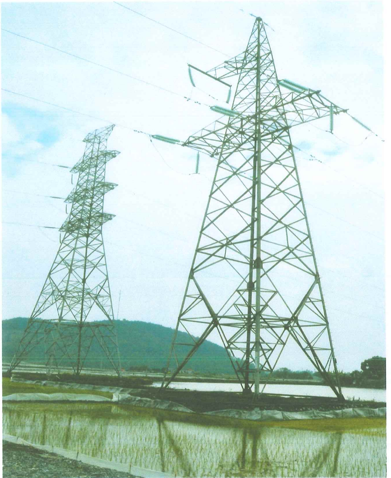
VỊ TRÍ 62 ĐZ 220KV 274 NS (E9.10) – 272 NC (E15.50)
