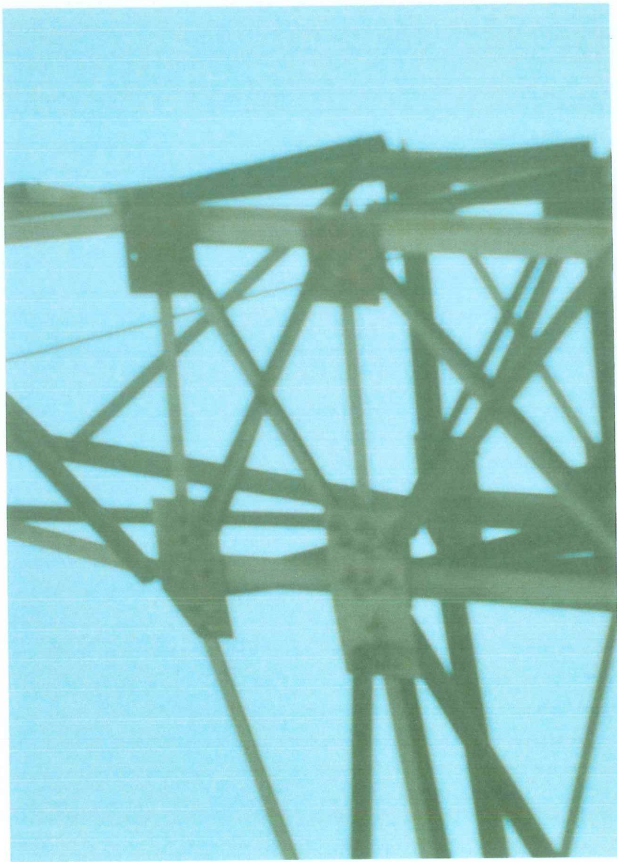
VỊ TRÍ 124 ĐZ 220KV 274 NS (E9.10) – 272 NC (E15.50)
