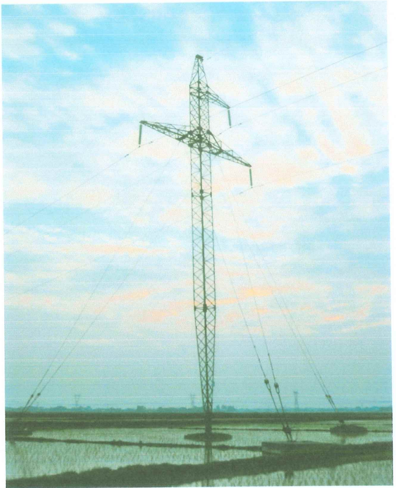
VỊ TRÍ 124 ĐZ 220KV 274 NS (E9.10) – 272 NC (E15.50)
