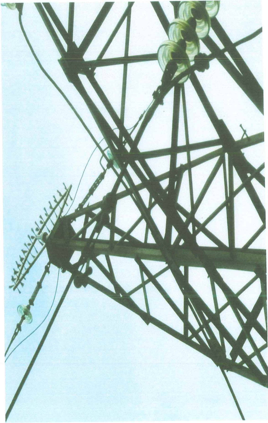
VỊ TRÍ 75 ĐZ 220KV 274 NS (E9.10) – 272 NC (E15.50)
