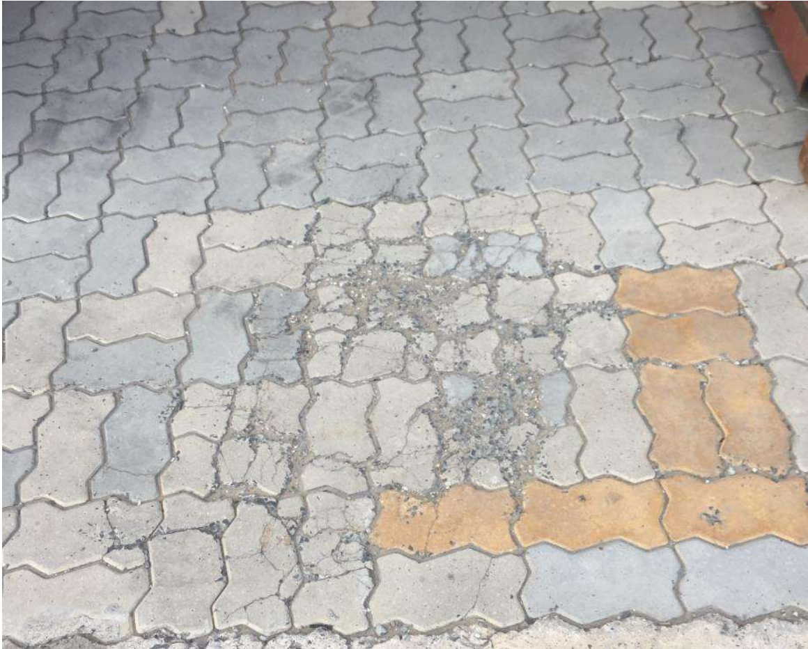
Hình 2. Mặt bãi line G17 (vị trí gạch bị vỡ)
