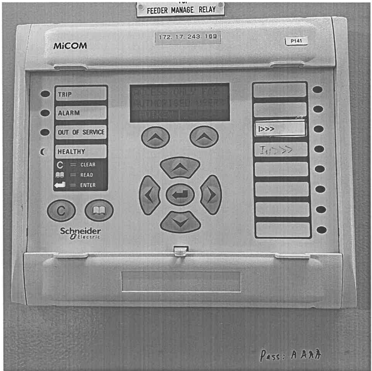
Hình ảnh mặt trước rơ le F50 ngăn 412 - TBA 110kV Hà Trung
