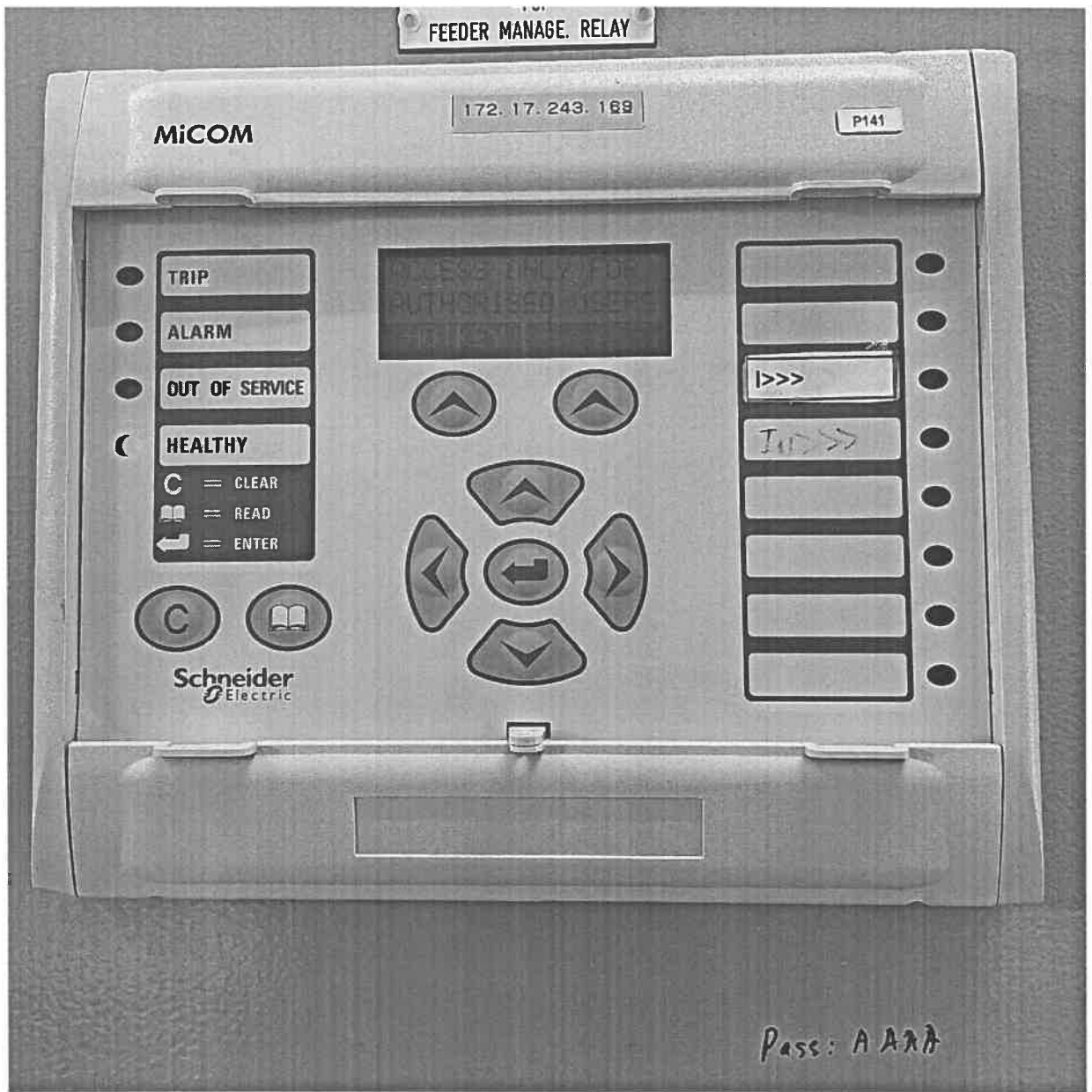
Hình ảnh mặt trước rơ le F50 ngăn 412 - TBA 110kV Hà Trung
