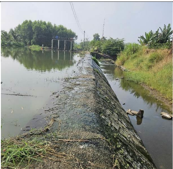
Hình Error! No text of specified style in document.-12: Hiện trạng tràn sự cố - vai phải
