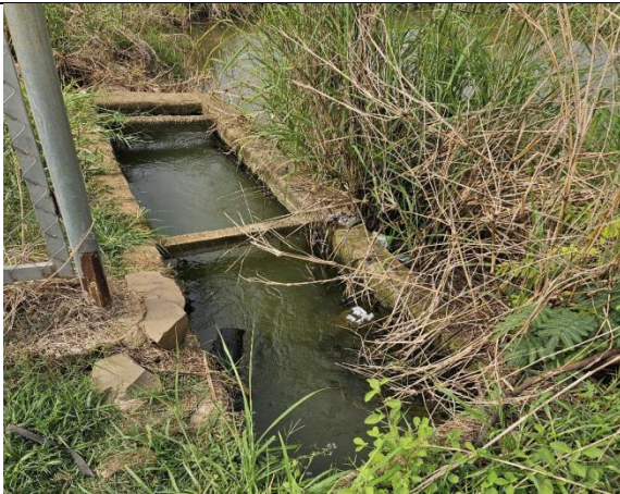
Hình Error! No text of specified style in document.-24: Hiện trạng kênh cấp nước – kênh cấp 2
