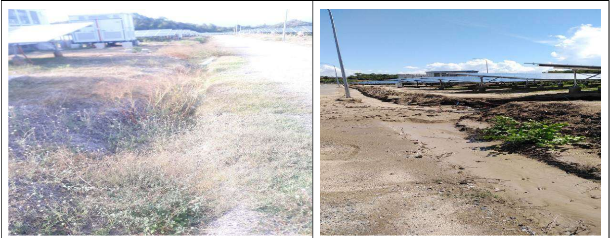
Hiện trạng rãnh thoát nước không gia cố đường giao thông số 6
