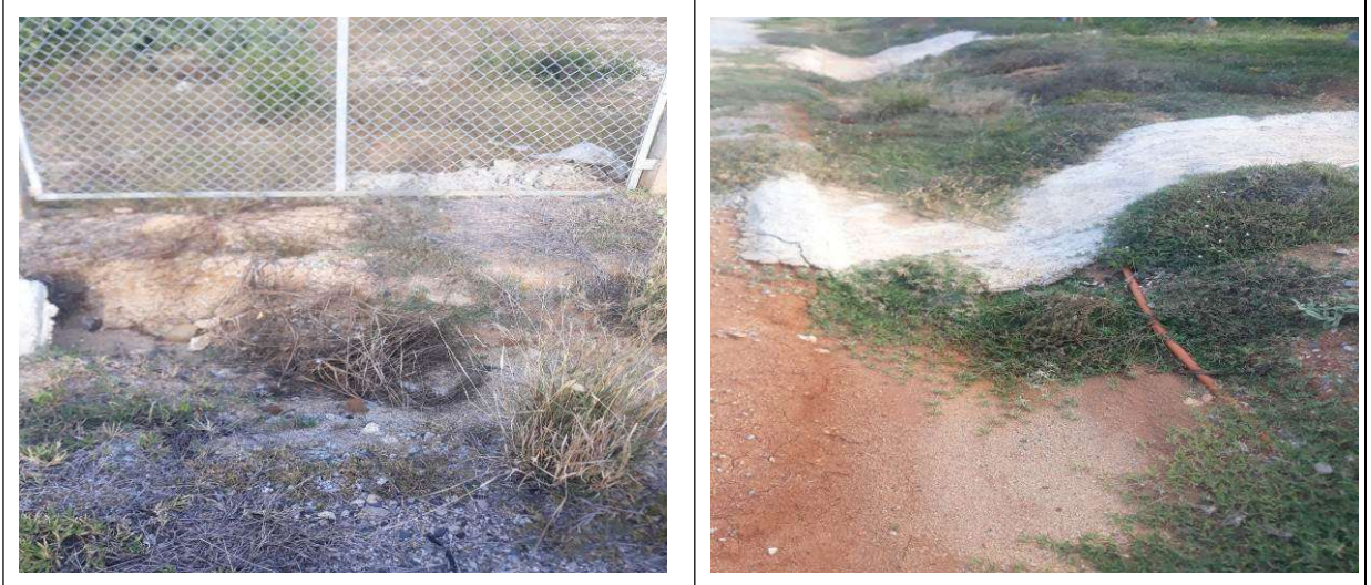
Hiện trạng rãnh thoát nước không gia cố đường giao thông số 8
